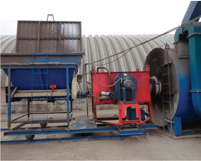
Рис. 6 – Паливозавантажувач ПЗА (зліва), пальник (по центру), теплообмінник (справа)
