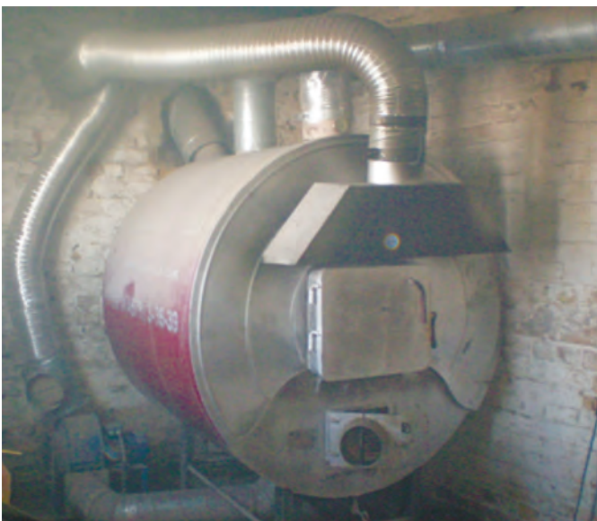
Рис. 2 – Загальний вигляд теплогенератора ТГУ
