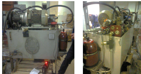
Рис.1. Загальний вид гідравлічної станції
