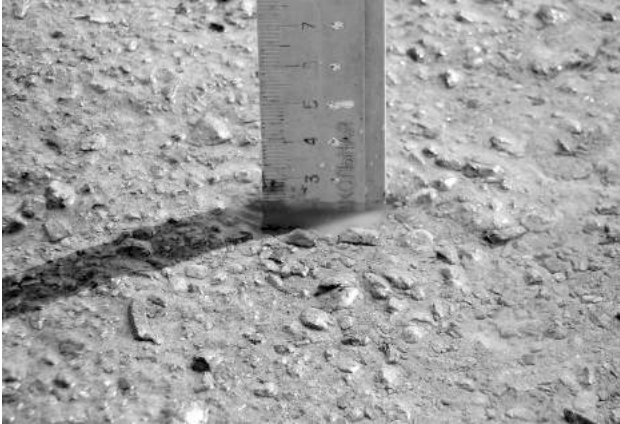
Рис. 5. Возможное состояние неподготовленной ВПП
