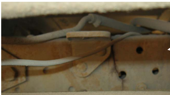
Рисунок 5 – Усталостные разрушения рамы
