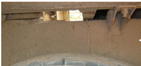
Рисунок 4 – Усталостные разрушения рамы
