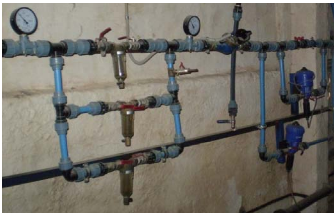
Рисунок 3 – Вузол водопідготовки ТББАВ
