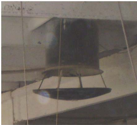
Рисунок 5 – Витяжна шахта системи вентиляції
