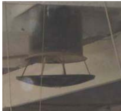
Рис. 13 – Вентиляційна витяжна шахта
