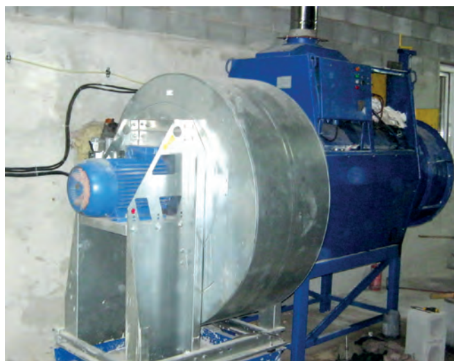
Рисунок 15 – Загальний вигляд теплогенератора у складі з вентилятором
