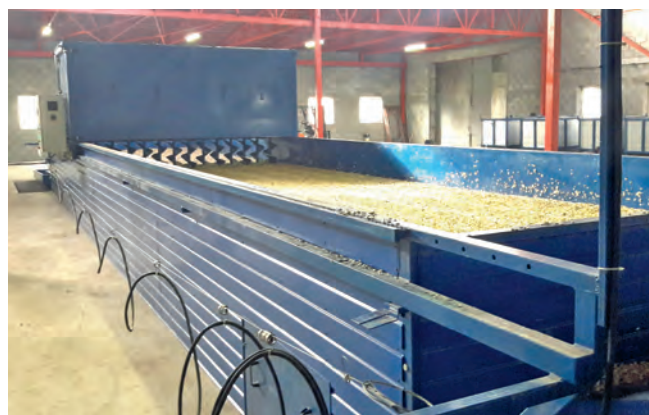
Рисунок 14 – Загальний вигляд рухомої балки сушильного столу на операції ворушіння
