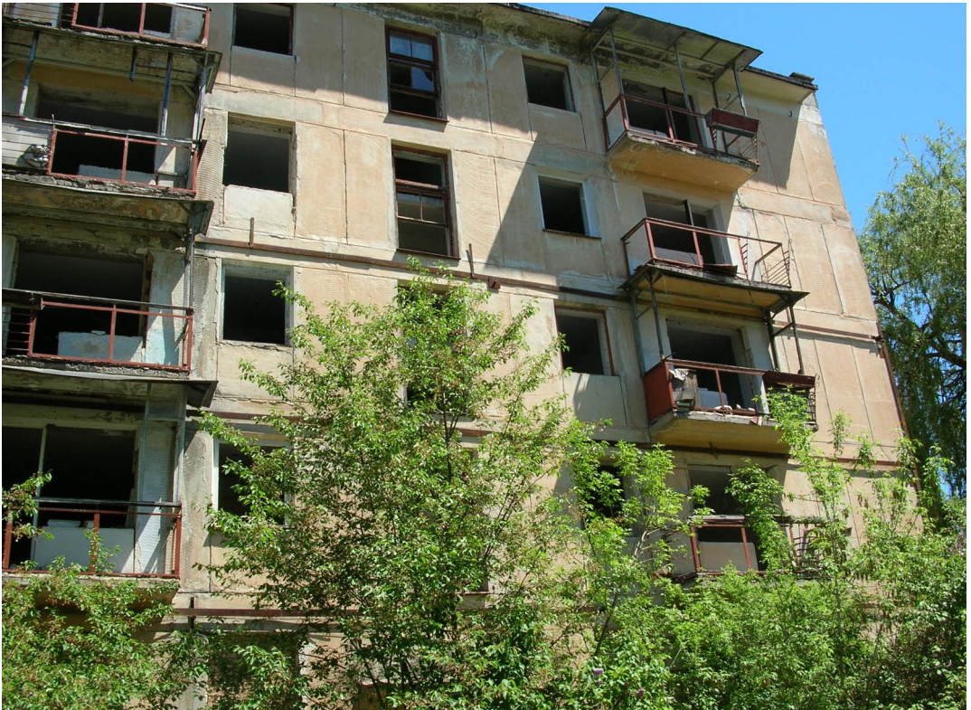
Фото 2. Зруйнований будинок по вул. Лескова, 45
