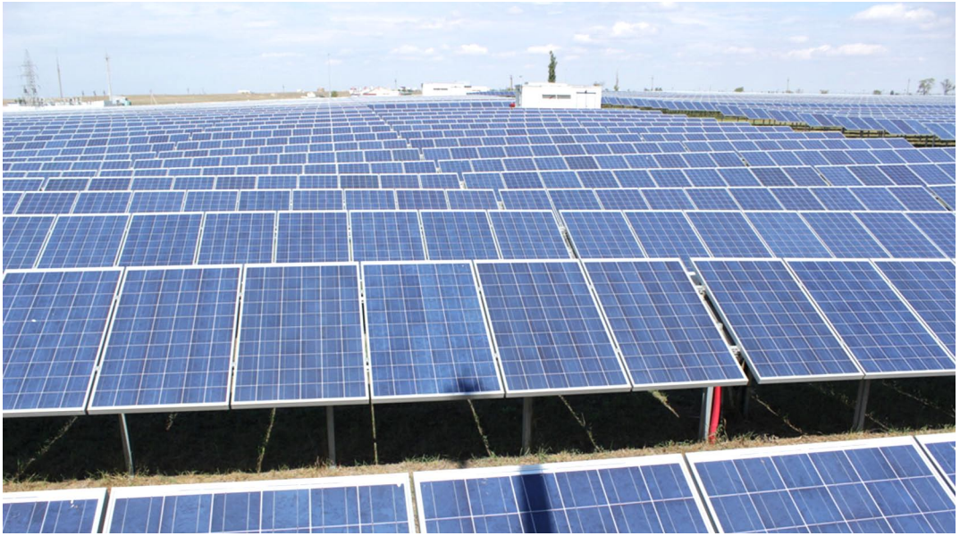
Фото 12. Общий вид одной из первых солнечных электростанций в Украине компании “Activ Solar” в с. Родниковое
