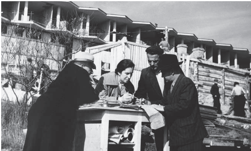
Іл. 1. Готель “Тарасова гора” у Каневі. Процес будівництва; в центрі — Н. Б. Чмутіна
