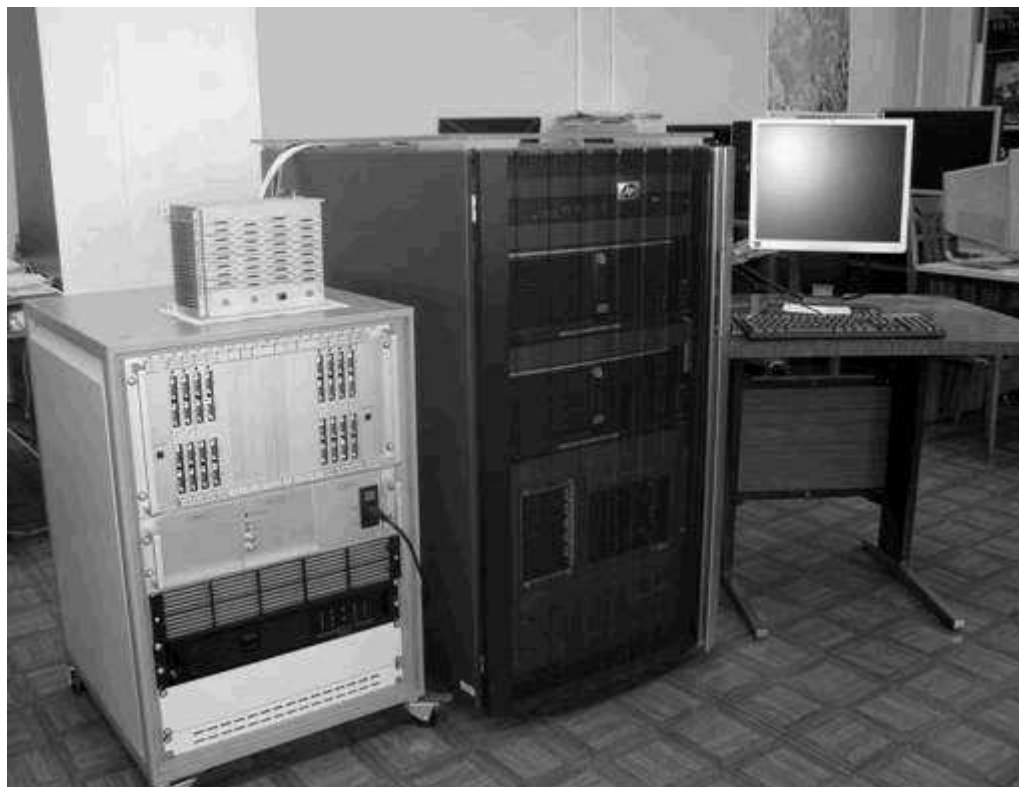
Рис. 5 – Внешний вид стендового оборудования.
