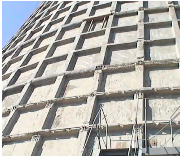
Рис. 6. Зовнішня поверхня оболонки градирні під час її ремонту та підсилення попередньо напруженими арматурними стрижнями в межах додаткових горизонтальних ребер жорсткості
