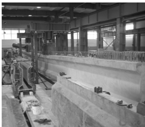
Рис. 3. Загальний вигляд випробування балки Б2100.110.40 на універсальному стенді (зліва – опалубка для бетонування балок)
