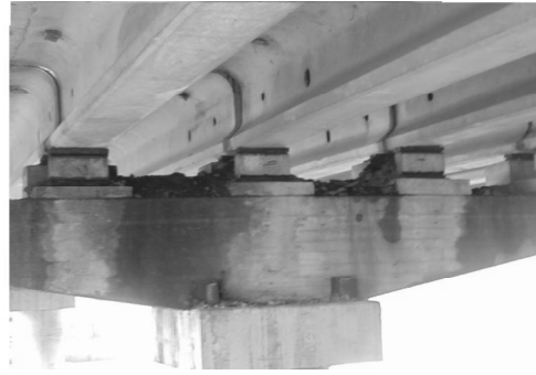
Рис. 2. Протікання води крізь дорожній одяг на елементи моста
