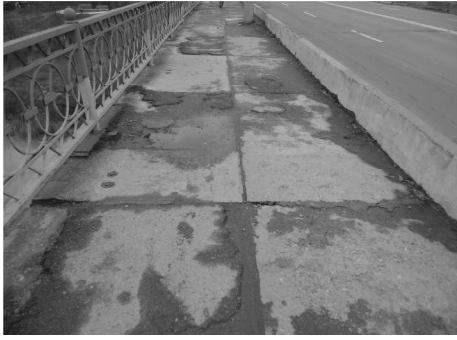
Рис. 1. Відсутність покриття та гідроізоляції на тротуарах
