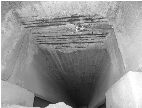
Рис. 3. Пошкодження захисного шару бетону, корозія арматури плити
