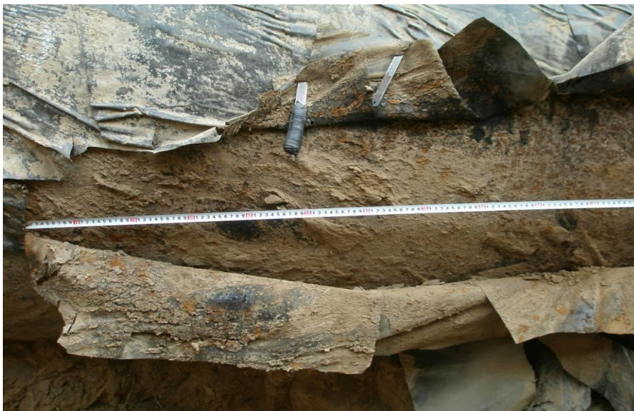
Рис. 2. Руйнування захисного ізоляційного покриття внаслідок дифузії через нього компонентів ґрунтового електроліту
