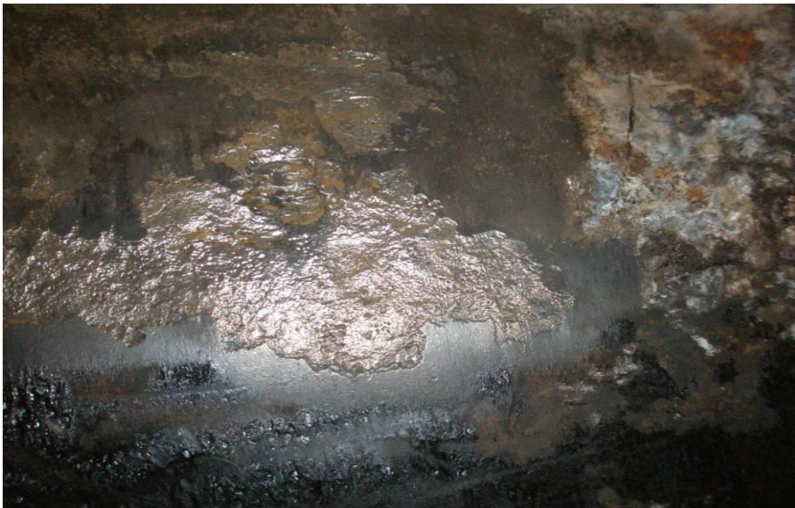
Рис. 1. Локалізоване корозійне ураження магістрального газопроводу ЄДК
