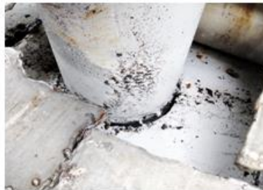
Рис. 9. Сквозное коррозионное разрушение сварных швов хранилищ
