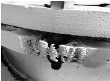
Рис. 8. Коррозионное разрушение основного металла фланцев хранилищ \text{HNO}_3 .
