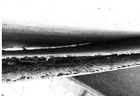
Рис.10. Расслаивающая коррозия в подкладных листах под опорами хранилищ
