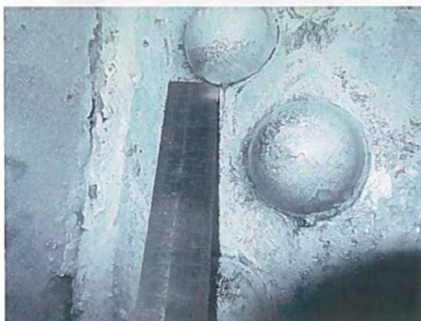
Рис. 5. Тріщина в хребтовій балці
