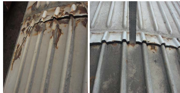
Рис. 2. Тріщини на вагонах-термосах моделі ТН 4-201 побудови заводу «Десау» Німеччина
