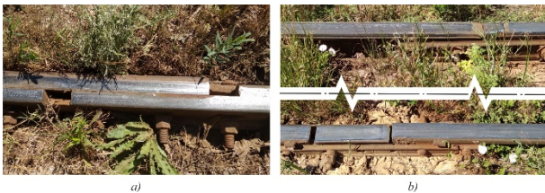
Рис. 2. Дефекты колеи в эксплуатации: а – зазор в стыке рельс, б - положение стыков вне плоскости поперечного сечения колеи
