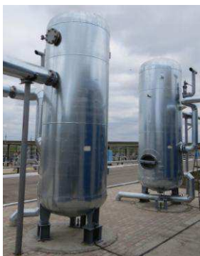
Рисунок 16 – Ресивери повітря і азоту станції ААВН-40/25 У1
