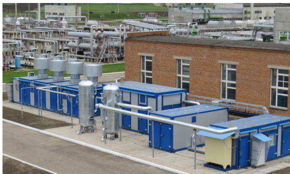
Рисунок 11 – Робота станції ААВН-40/25 У1 на Котельвському ГРП
