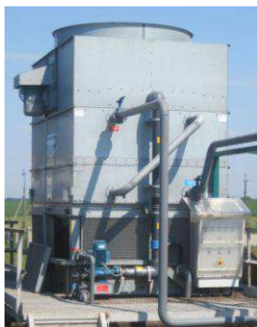
Рисунок 17 – Охолоджувач теплоносія станції ААВН-40/25 У1
