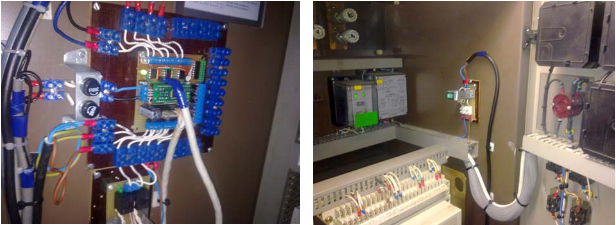
Рис. 3. Внешний вид дополнительной защиты от повышенного напряжения в судовой сети
