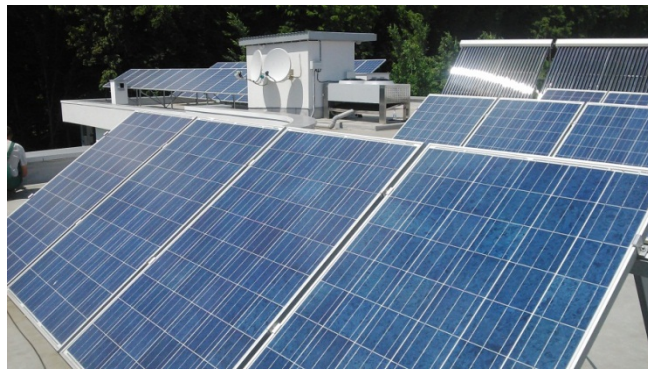
Рис. 4. Сонячна електростанція потужністю 12 кВт (м. Хмельницький)
