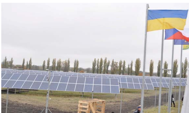
Рис. 1. Сонячна електростанція (с. Ясенівка, Хмельницька область)
