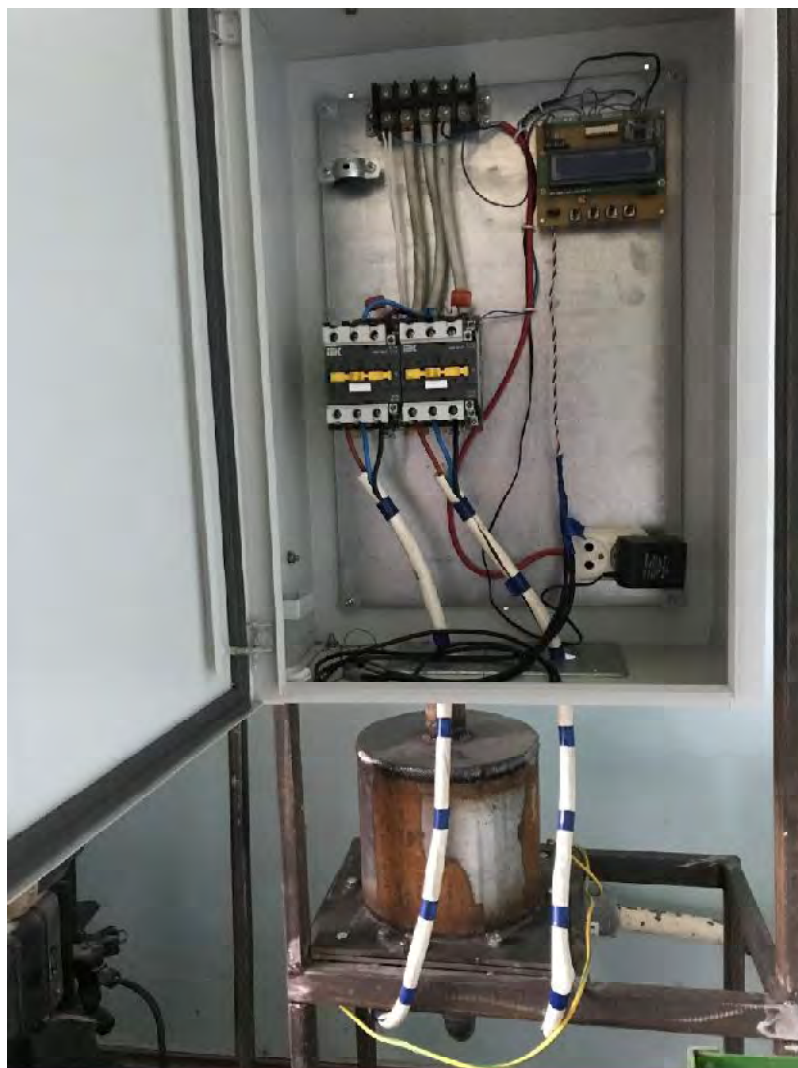
Рис. 4. Загальний вигляд змонтованого в окремому модулі системі теплопостачання електродного котла на 35 кВт та блоку його управління
