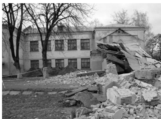
Рис. 5. Часткове обрушення будівлі колегіуму № 11, м. Чернігів
