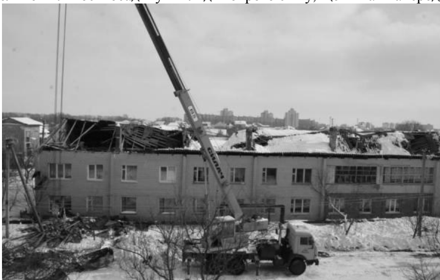
Рис. 2. Обрушення даху багатоквартирного житлового будинку, м. Чернігів
