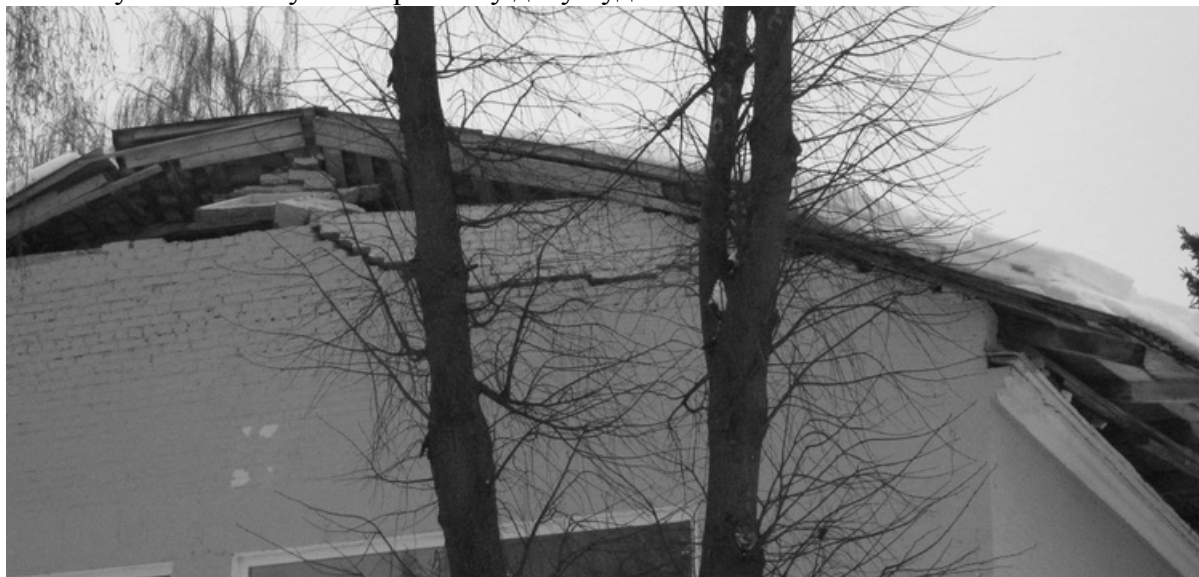
Рис. 3. Обрушення даху дитячого будинку, м. Чернігів
