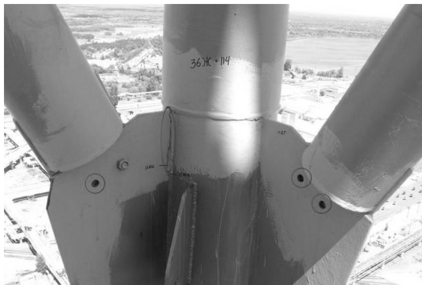
Рис. 8. Відсутність болтових з'єднань нової вентиляційної труби (НВТ-2) Чорнобильської АЕС
