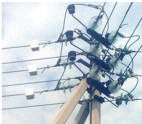
Рисунок 1 – Датчики регистрации аварийных событий на ВЛ в сети 10кВ
