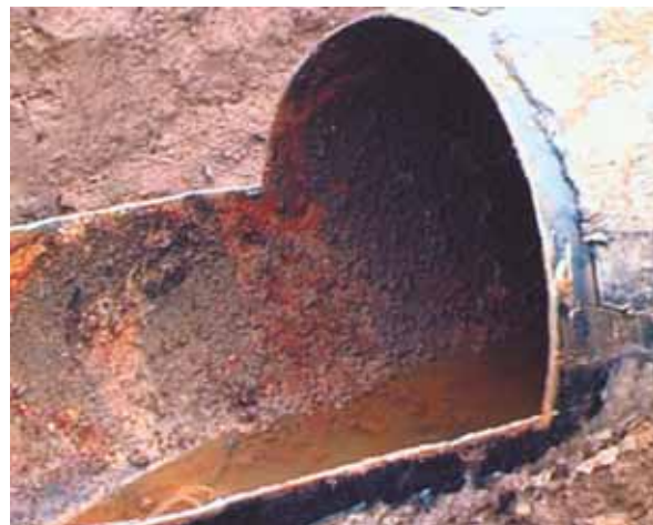
Рисунок 1. Внутренняя поверхность трубопровода до обработки
