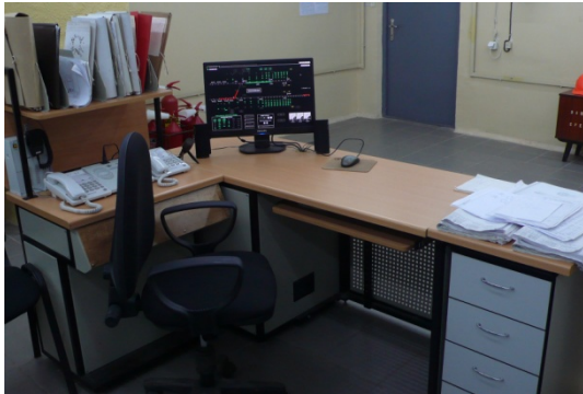
Автоматизированное рабочее место электромеханика СЦБ станции «Алексеевская» КП «Харьковский метрополитен»
