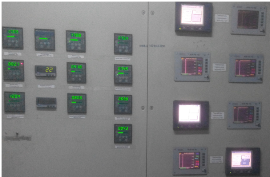
Рисунок 2 – Цеховой контрольный щит одной технологической секции обогатительной фабрики
