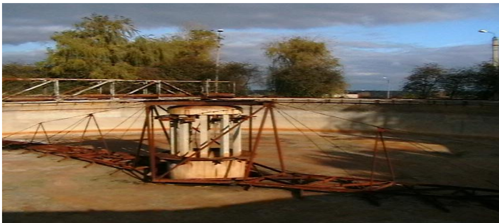
Рис. 2. Радіальний відстійник (очисні споруди м. Херсона)
