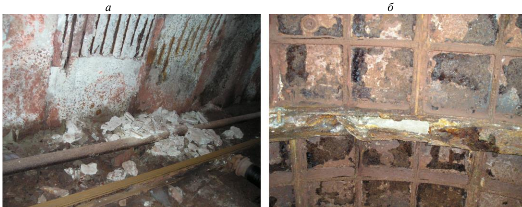
Рис. 3. Разрушение крепления наклонных горных выработок: а - армоблочное крепление; б - тюбинговое крепление
