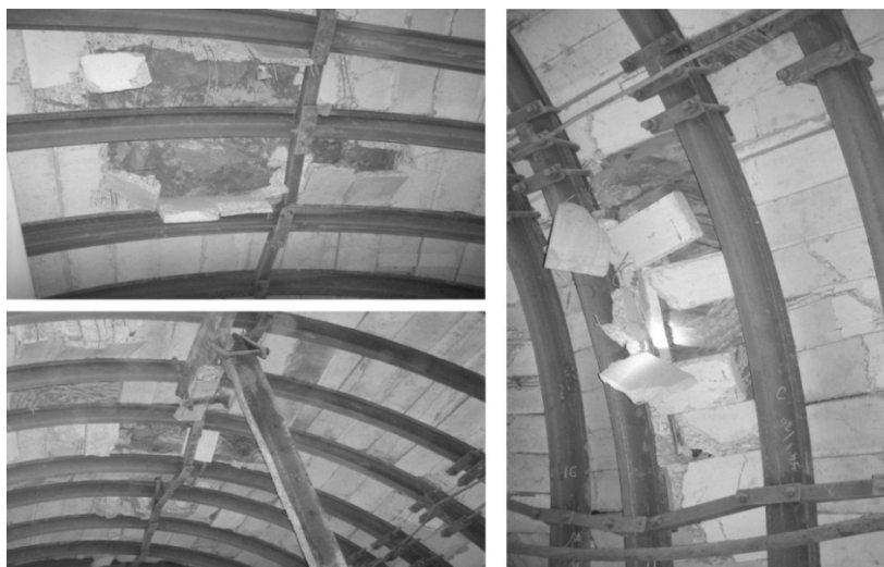
Рис.1. Деформация межрамных затяжек
