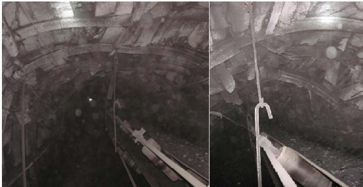
Рис. 1. Примеры деформации крепи южного уклона II ступени пл. I 1 в районе ПК16
