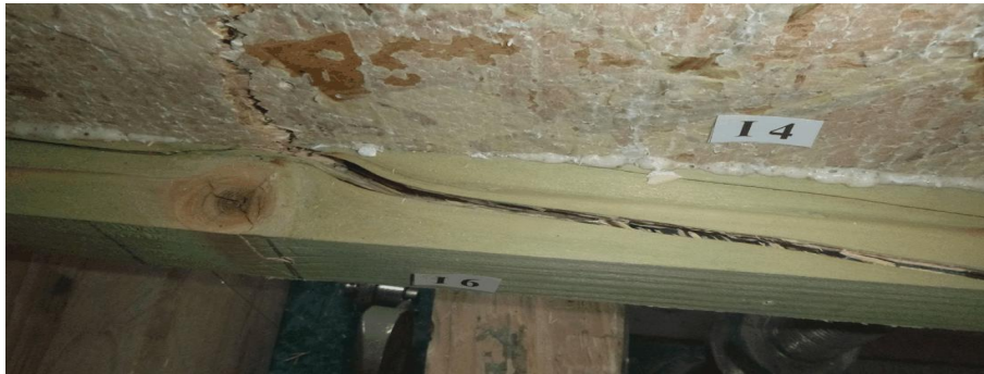
Рис. 6. Місце руйнування розтягнутої полицки балки Б-1.
