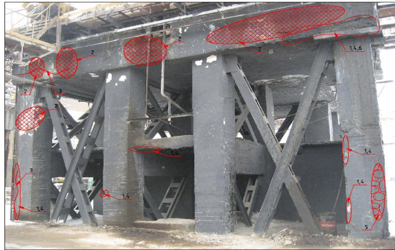
Рис. 3. Дефекти і пошкодження опори П6/О4: 1 – сколення бетону; 2 – корозія та руйнування бетону; 3 – тріщини; 4 – оголене (корозія) арматури; 5 – відшарування (руйнування) бетону; 6 – пори, раковини бетону.
