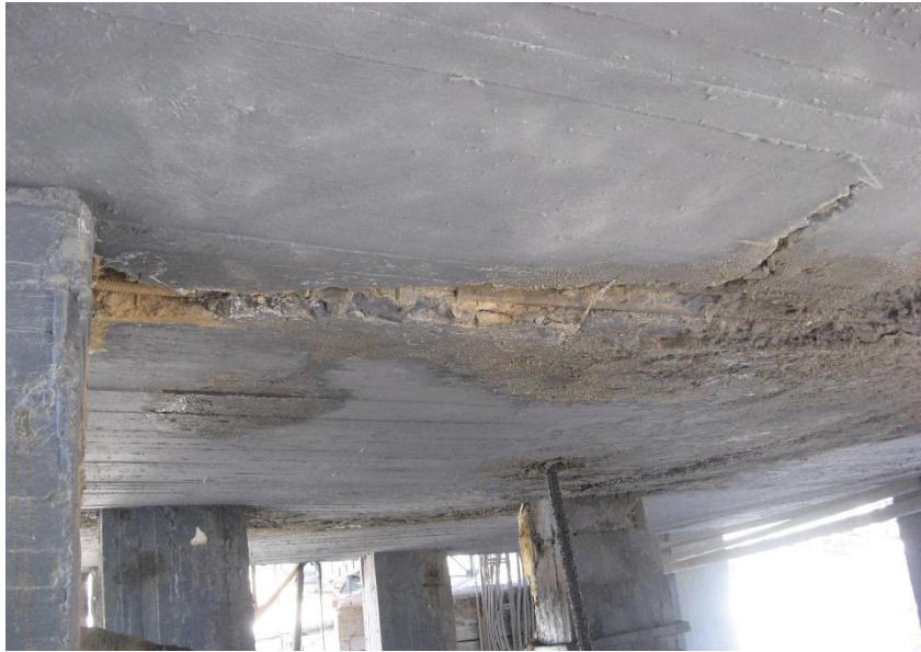
Рис. 6. Тріщини у нижній зоні верхньої плити опори П5/О4.
