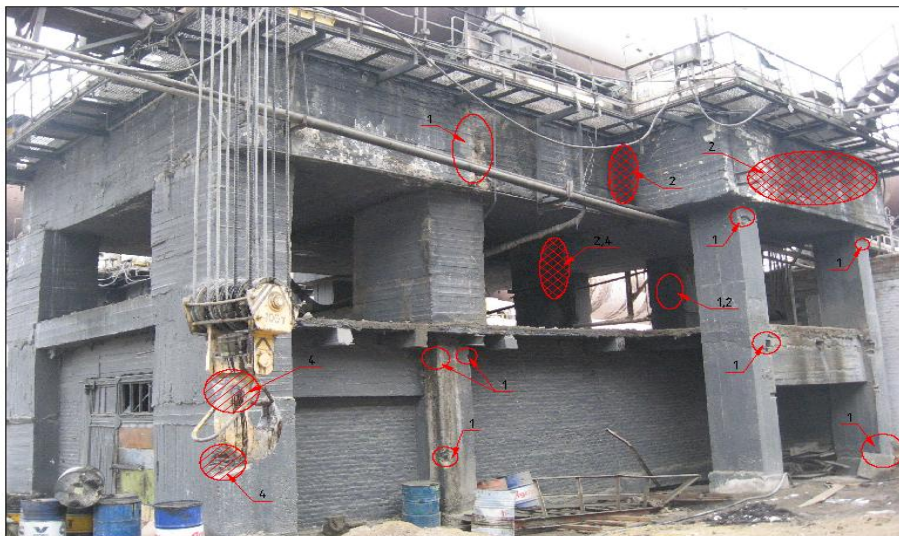
Рис. 4. Дефекти і пошкодження опори П5/О4: 1 – сколення бетону; 2 – корозія та руйнування бетону; 3 – тріщини; 4 – оголення (корозія) арматури.
