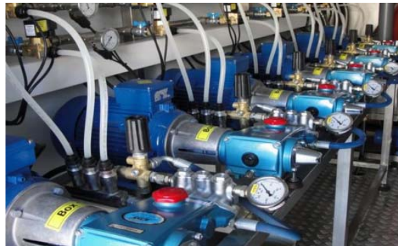
Rys.10. System pompowy myjni [11]
