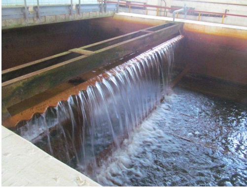
Рис. 3. Аераційний жолоб та фільтр № 3 водоочисної станції № 2
