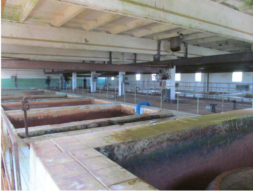
Рис. 1. Фільтрувальна зала водоочисної станції № 1 Горбаківсько-Гориньградського водозабору
