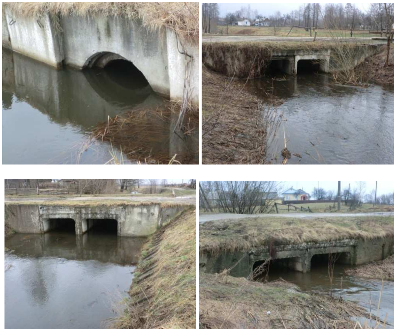
Рис. 6. Переїзди, в яких спостерігаються перекіс, лущення бетону, замулення, проростання трави та підмив споруди
