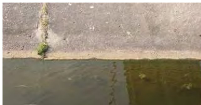
Fot. 4. Widoczne porastające mchy w połączeniach płyt betonowych
