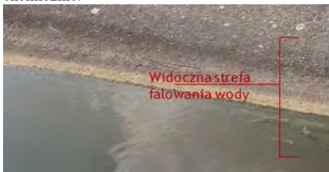
Fot. 3. Uszkodzona powierzchnia betonowa w strefie falowania wody
