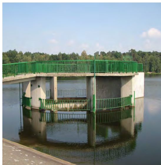
Fot. 6. Wieża upustowa i skarpa odwodna zbiornika Pokrzywnica – przybliżenie (widoczne miejsca ubytków betonu w następstwie procesu karbonatyzacji)
