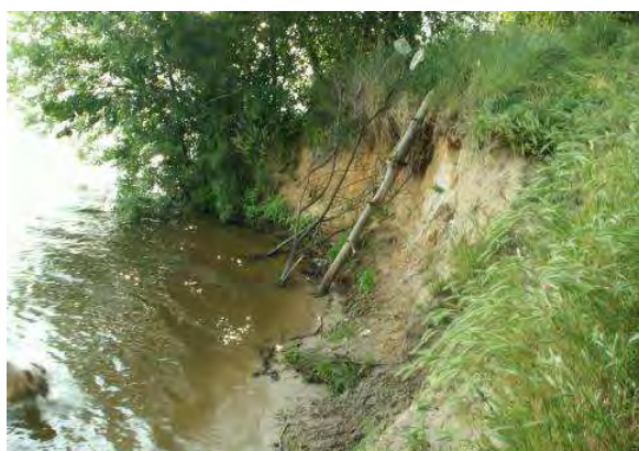
Fot. 11. Zbiornik Pokrzywnica – abrazja brzegów od strony północnej w części środkowej akwenu
