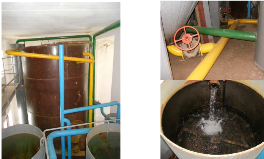
Рис. 2. Пінополістирольні фільтри з технологічними трубопроводами
