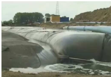
Рис. 11. Процес витікання води через стінки геотуби швидкого зневоднення
