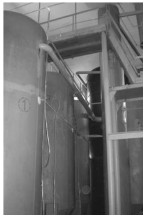
Рис. 3 Обладнання фільтрів п'єзометричними трубками
