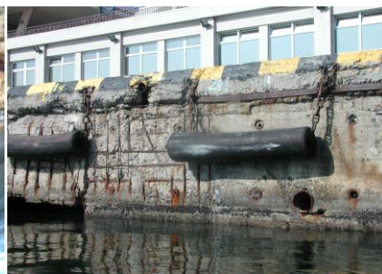
Рис. 2. Разрушение бетона бортовой балки и верхнего строения (до реконструкции)
