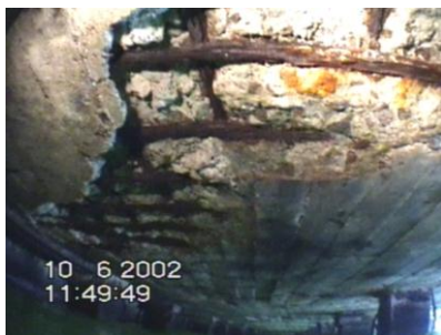
Рис 1. Разрушение бетона с оголением и коррозией арматуры (верхнее строение)
