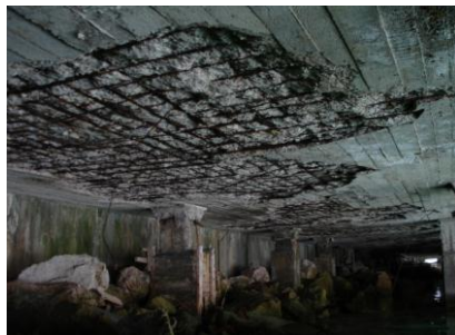
Рис. 4. Разрушения бетона нижней поверхности верхнего строения
