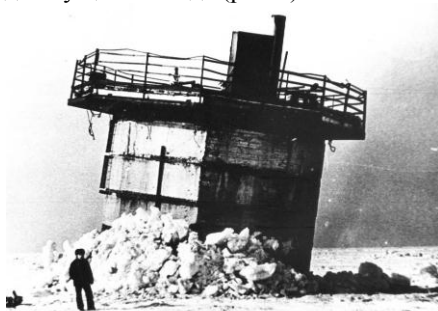
Рис.1. Аварийный наклон железобетонной опоры под воздействием льда
