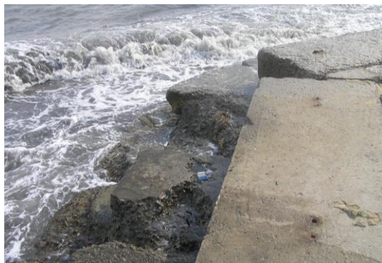
Рис.3. Локальное разрушение железобетонного ступенчатого массива
