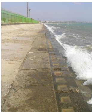
Рис.2. Смещение элементов берегозащитного сооружения от проектного положения
