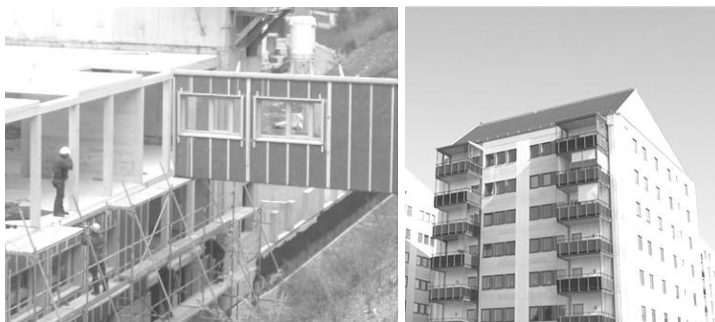
Рис. 3 Многоэтажные дома с деревянным каркасом а - деревянный каркас в процессе возведения; б - завершенное здание
