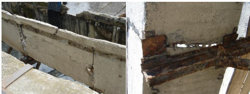
Рис.2. Разрушение железобетонных конструкций. Полностью прородированные металлические конструкции
