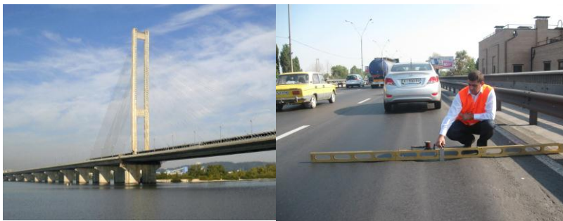
Рис. 1 Измерение автором величины колеи на асфальтобетонном покрытии на эстакадной железобетонной части Южного мостового перехода
