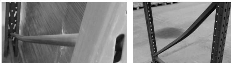
Рис. 5 Дефекти розкосів (місцеві погини)
