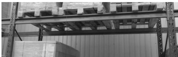
Рис. 3 Дефект траверси для розміщення палет (наднормативний прогин – залишкові деформації траверс внаслідок перевантаження)
