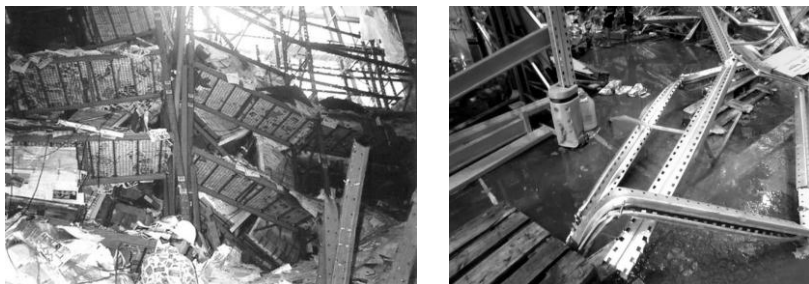
Рис. 2. Зруйновані стелажі і пошкоджені ТМЦ
